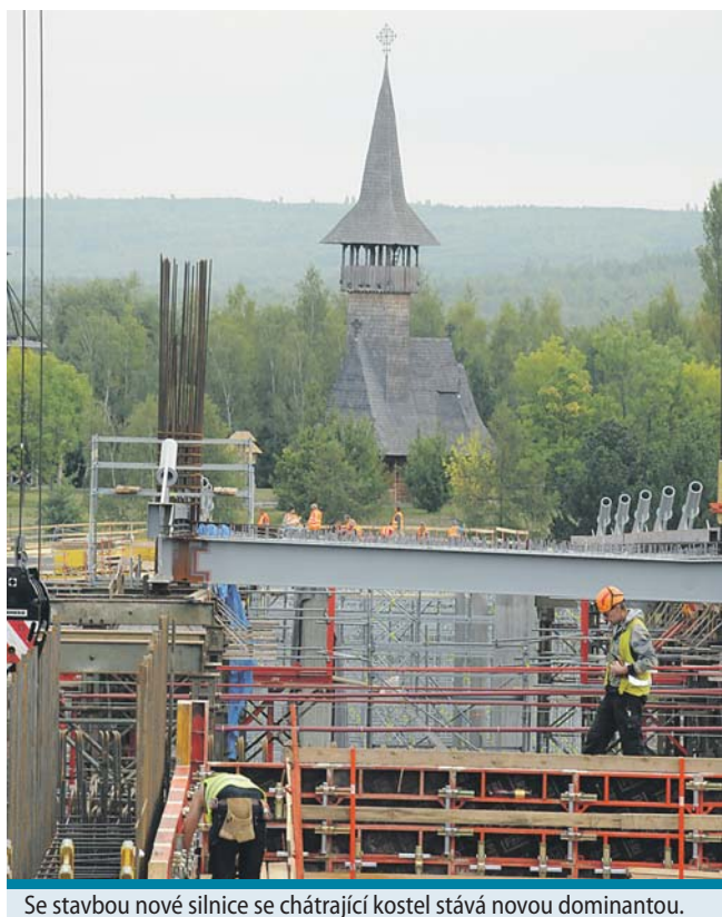
Se stavbou nové silnice se chátrající kostel stává novou dominantou.
